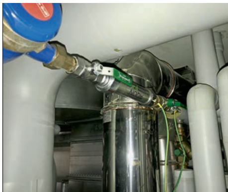
AQON Pure wurde in der Hauptwasserleitung verbaut.
